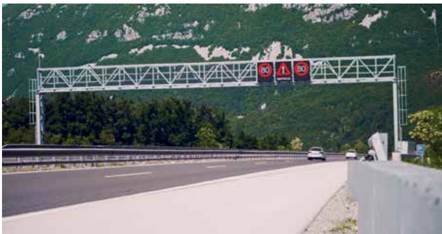
Slika 39: Spremenljiva signalizacija in Regionalni nadzorni center Kozina
